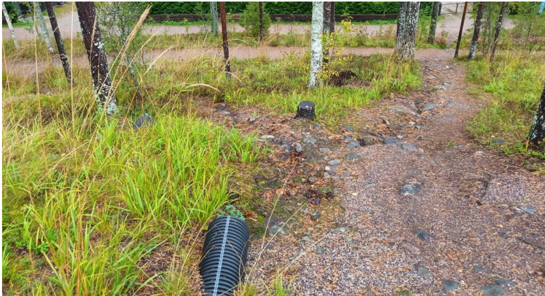
Kuva 15. Kalevantien purkupäässä on havaittavissa huomattavaa eroosiota. [Ramboll 17.9.2025]
